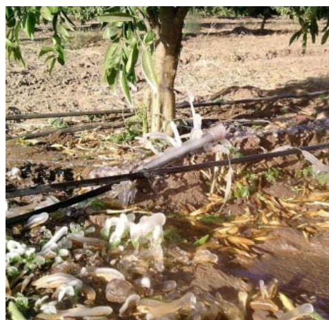
Imagen 1.3 Tuberías congeladas por efecto de la helada de febrero de 2011.
